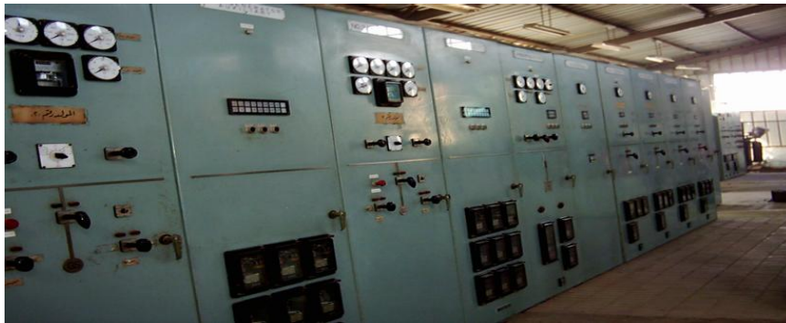
لوحة تشغيل محركات جهد متوسط ٣ و ٣ ك.ف داخل مبنى
